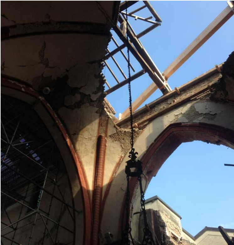
Sfondamento di strutture voltate in muratura a seguito di scosse sismiche.
