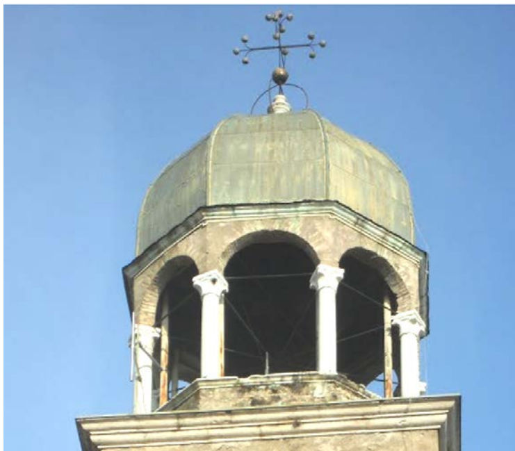
Salò (BS), Duomo: intervento post-sisma sulla lanterna. Messa in opera di un sistema di tiranti d'acciaio ad integrazione del controventamento metallico preesistente.
