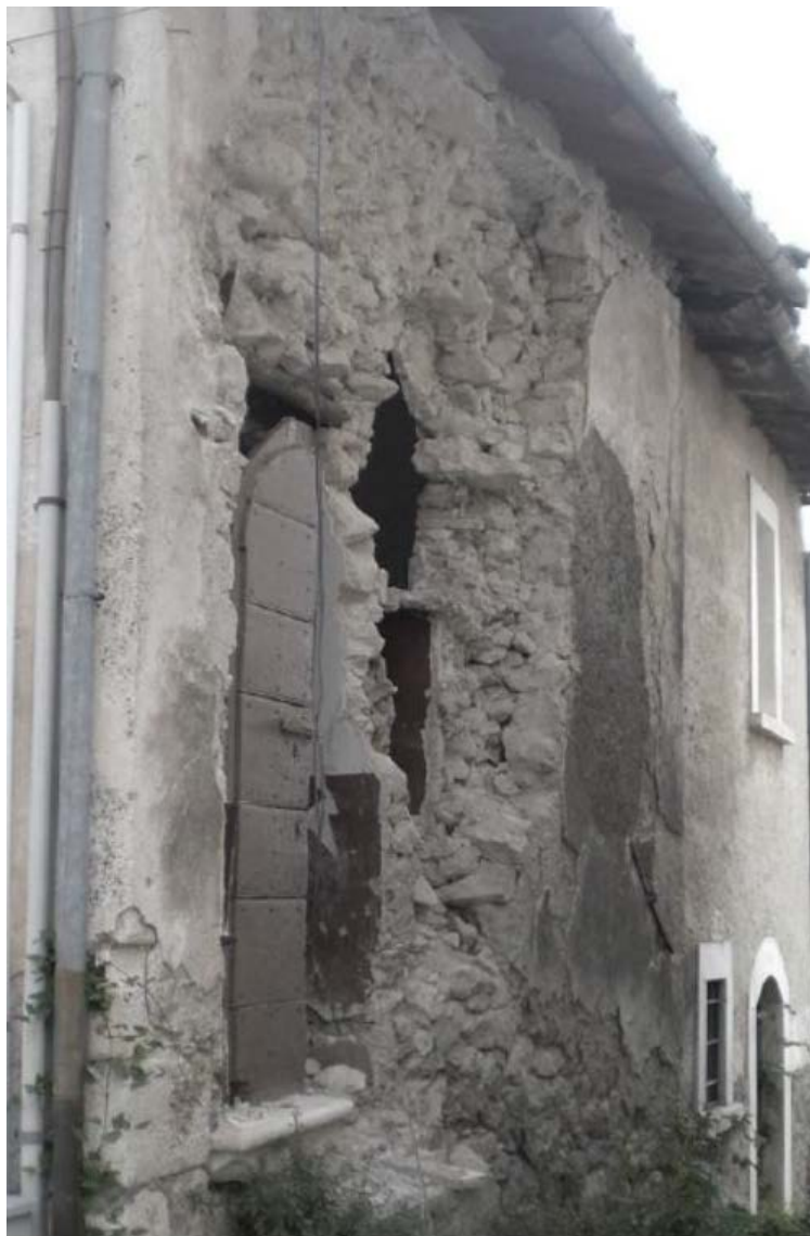
L'Aquila 2009: esempio di scarsa qualità muraria delle costruzioni storiche.
