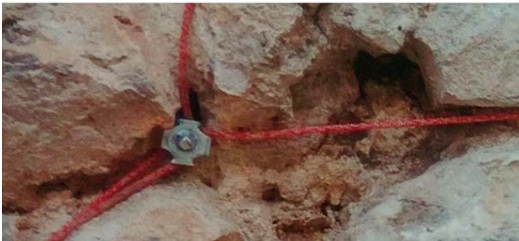
L'intervento di rinforzo delle murature storiche con paramenti a vista mediante il metodo del Reticolatus (prof. ing. A. Borri).
